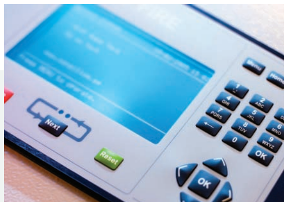
Fig. 4 - Il pannello centrale di segnalazione allarme incendio Salwico Fire alarm central panel Salwico
